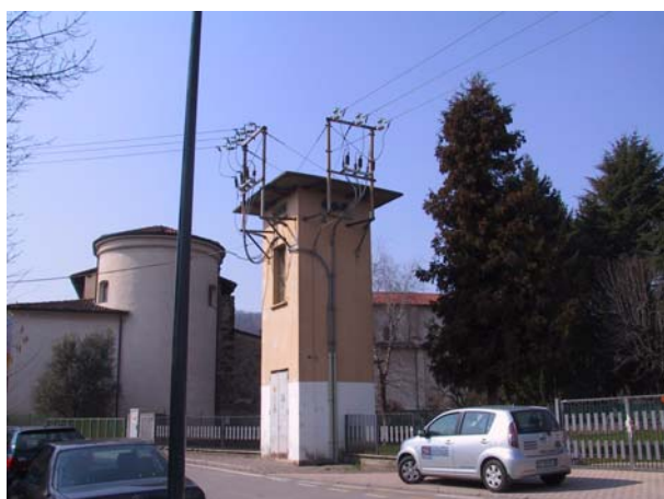
Foto 11: Cabina di trasformazione M.T./B.T. in via Papa Giovanni XXIII.
