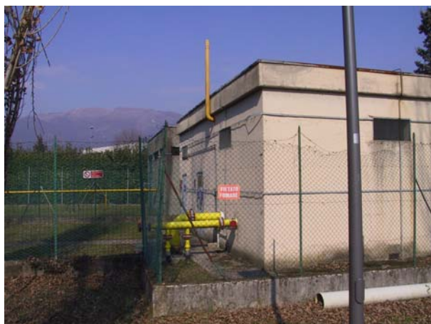
Foto 13: Cabine del metano in via Kennedy.
