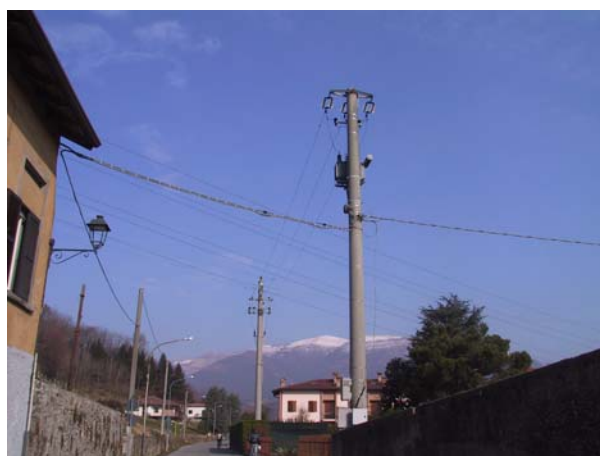
Foto 12: Cabina di trasformazione M.T./B.T. su palo in via Kennedy.
